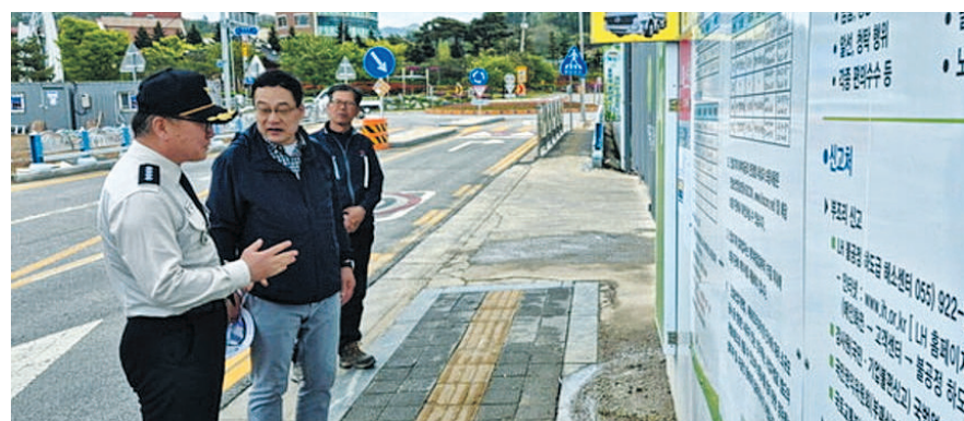
최경천 장수소방서장이 25일 장수읍 소재 LH임대 아파트 건설현장을 찾아 화재예방과 안전환경 조성을 위한 현장 지도점검을 실시했다.
